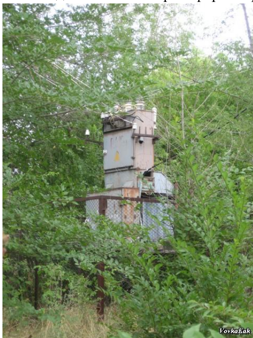
Рис. 44. На месте участка Райт Юлиуса теперь стоит силовой трансформатор. — Фото В. Какорина, 2009 г.
